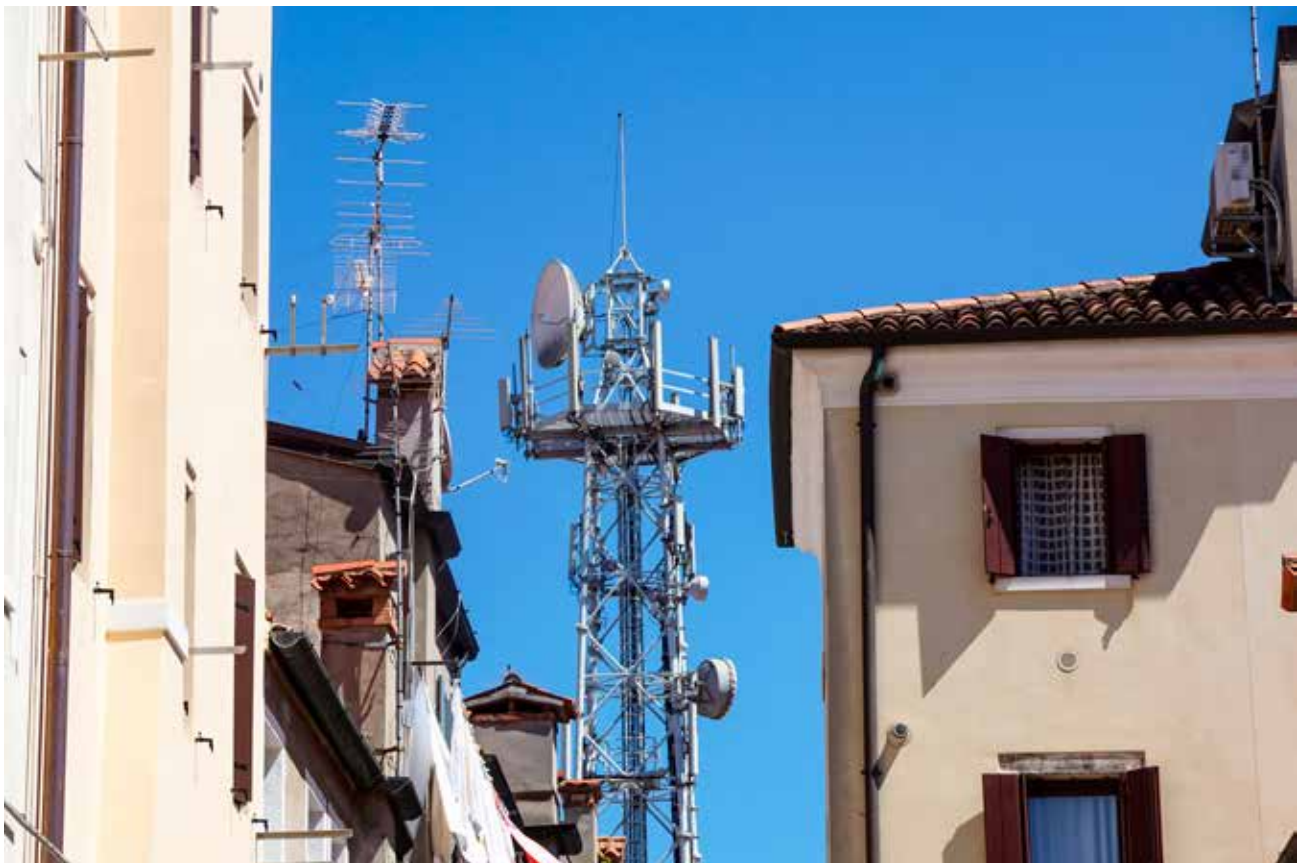
Fast höghastighetsbroadband via 5G möjliggörs inom en snar framtid med InCoax teknik för s k 5G (mmWave) FWA.
